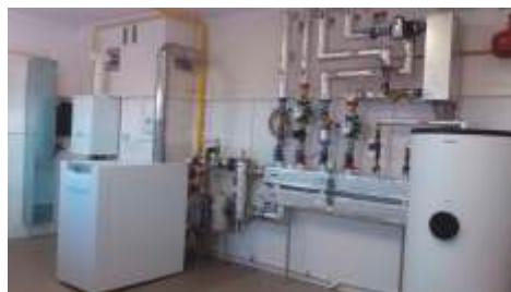
Kotłownia gazowa o mocy 175kW – w budynku Hurtowni farmaceutycznej NEXTER w Przyszowicach, wraz z instalacjami: a. instalacje centralnego ogrzewania, b. instalacje wodno-kanalizacyjne, c. sieci zewnętrzne – instalacja wody deszczowej, instalacja kanalizacji sanitarnej, przyłącze gazu, przyłącze wody.
